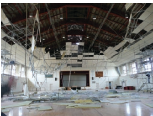
東日本大震災における非構造部材の被災状況
